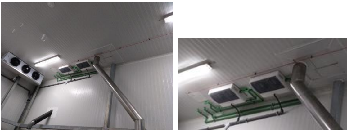
Enfriadores en cubierta
